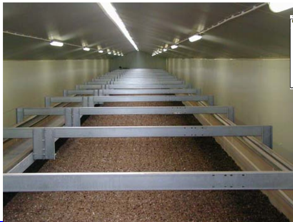
Séchoir à fumier intérieur
